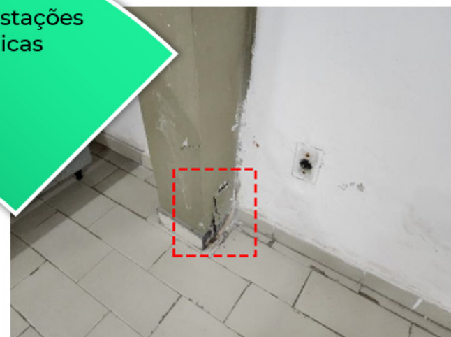
Corrosão de armaduras em pilar no corredor
