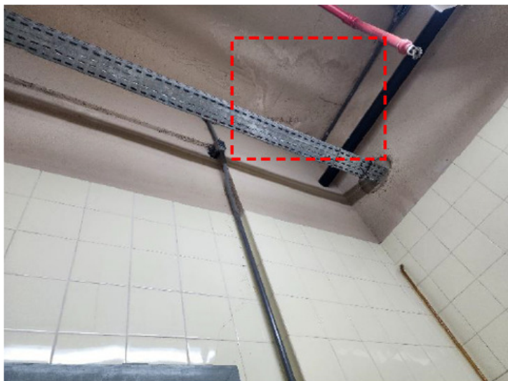
Empolamento de pintura na laje
